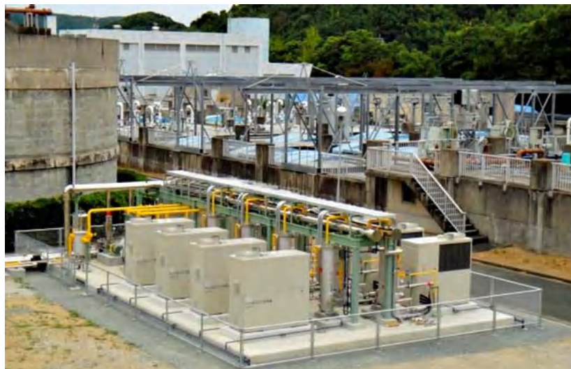
■消化ガス発電システム
