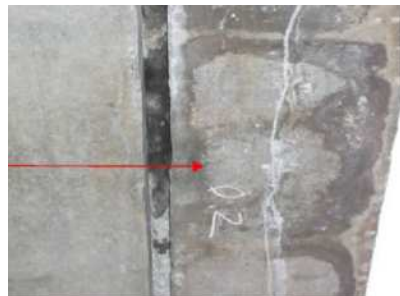
ひびわれ・漏水・遊離石灰
