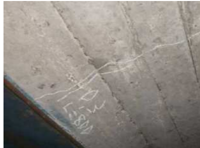
床板ひびわれ
