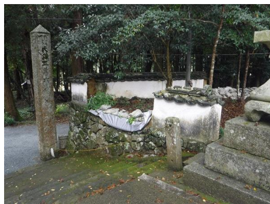
崩壊した箇所がみられる八所宮の土塀
