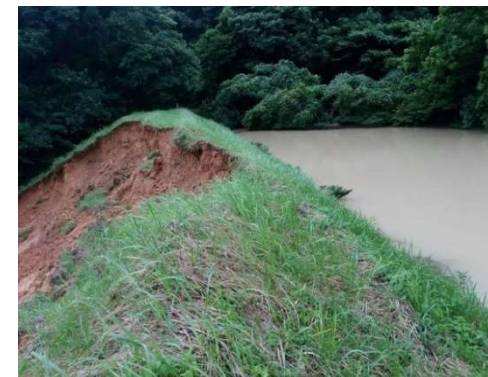
西日本豪雨で被災した御手水池
