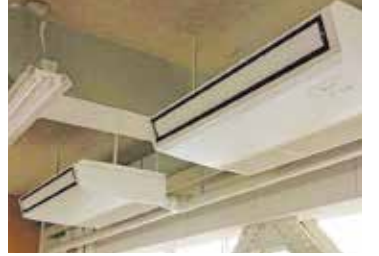
普通教室に設置した空調設備
