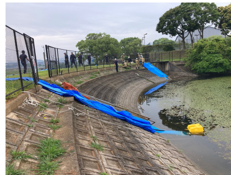
排水ポンプ稼働訓練
