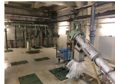
神湊汚水中継ポンプ場
