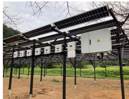
営農型太陽光発電設備
