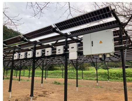
営農型太陽光発電設備
