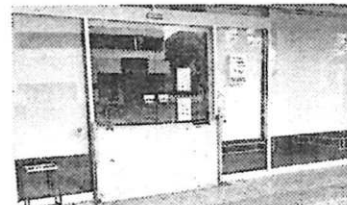
田久の店舗に設置されている「止水板」
