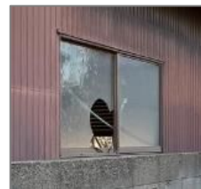
窓が割れた管理不全空家
