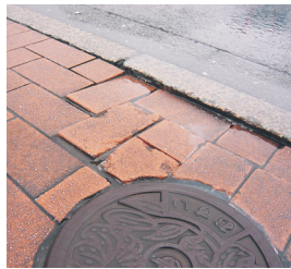
段差が生じている歩道
