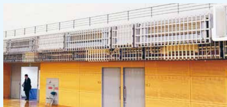
すでに空調が整備された城山中学校体育館
