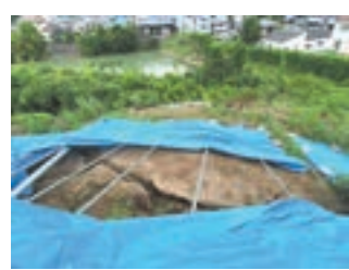
崩壊した三倉池周辺の様子
