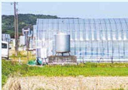
燃油を使用しているいちごハウス
