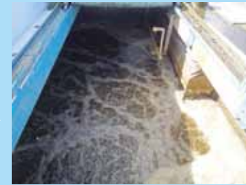
せいぶつはんのうそう ③生物反応槽
