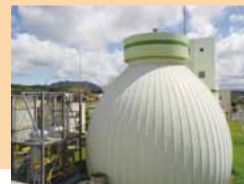
おでいしょうか らんけい ⑩汚泥消化タンク (卵形)
