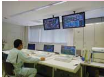
ちゅうおうかんしつ 中央監視室
