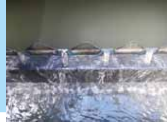
さいしよちんでん ち ②最初沈殿池
