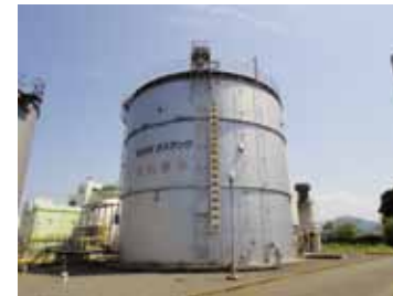
⑫ガスタンク
