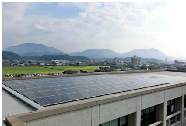
■市役所屋上の太陽光発電システム
