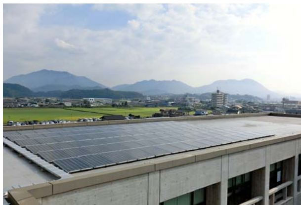
■市役所屋上の太陽光発電システム
