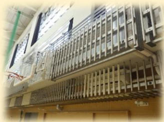
全市立学校の体育館に整備した空調設備
