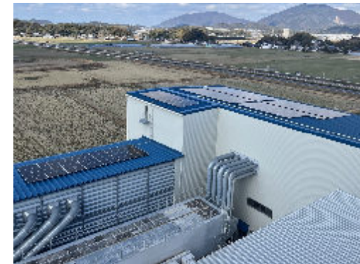
太陽光発電設備（100kW） （光岡カントリーエレベーター）
