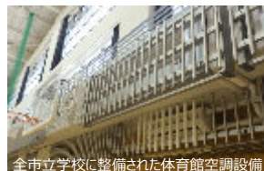
全市立学校に整備された体育館空調設備
