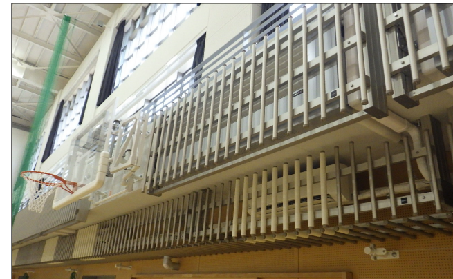
城山中学校体育館に整備した空調設備
