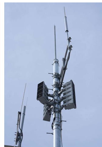
再整備した防災行政無線
