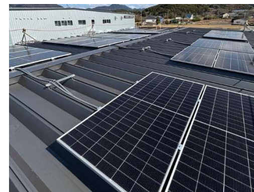
事業所に設置した太陽光発電設備
