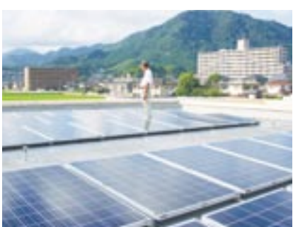
屋上に設置された太陽光パネルを確認する太田さん
