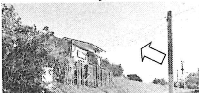
電線に絡んでいた草も処理 (2026年1月)
