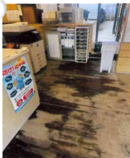
赤間駅前冠水による、床上浸水
