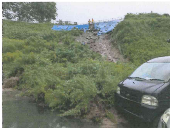
日の里コミセン下の土砂崩れ
