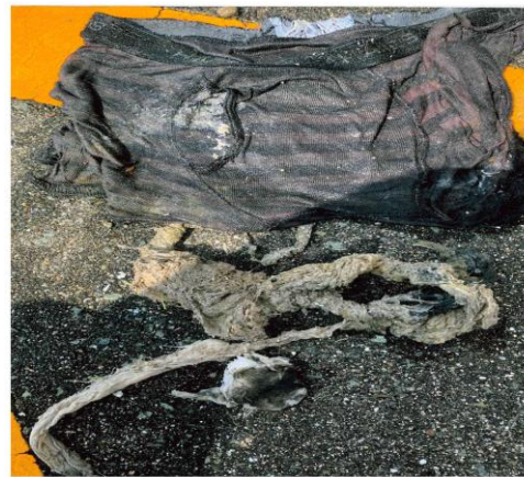
↑ ポンプから取り出された異物
