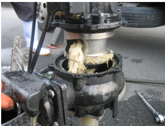
↑ ポンプ羽根に異物が絡まった状態
